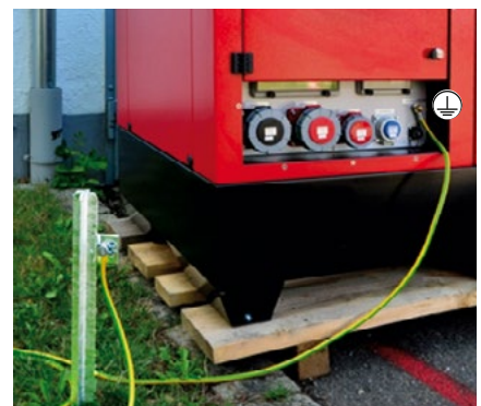
Abb. 15 Stromerzeuger mit Erdungsanschluss und Erdspeiß
