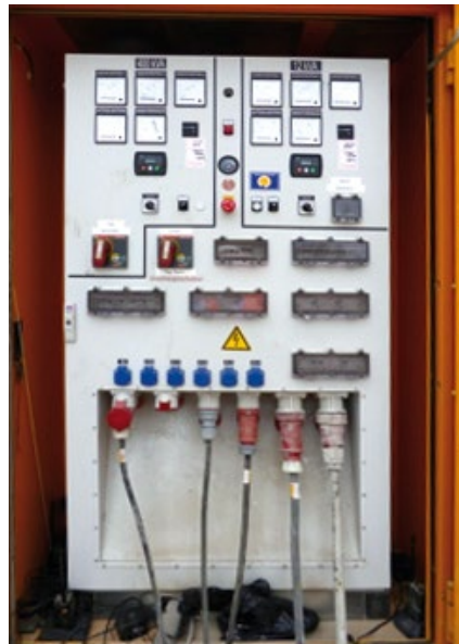
Abb. 14 Anschlussfeld eines Stromerzeugers mit integrierten RCDs
