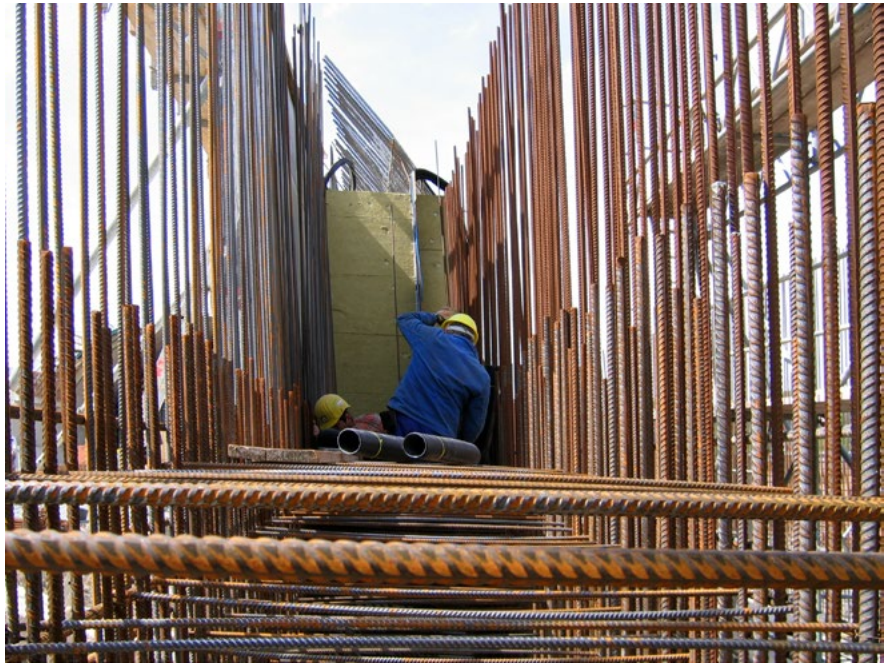
Abb. 19 Beispiel für erhöhte elektrische Gefährdung
